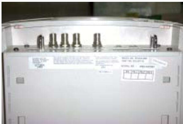
Base avec anciennes étiquettes Mise à jour nécessaire
