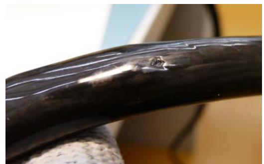
Figure 8 : Câble Moteur endommagé
