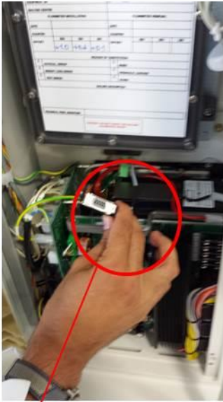
Connecteur DFL-1 débranché du capteur du débitmètre massique
